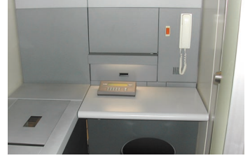
本店貸金庫室操作ブース
